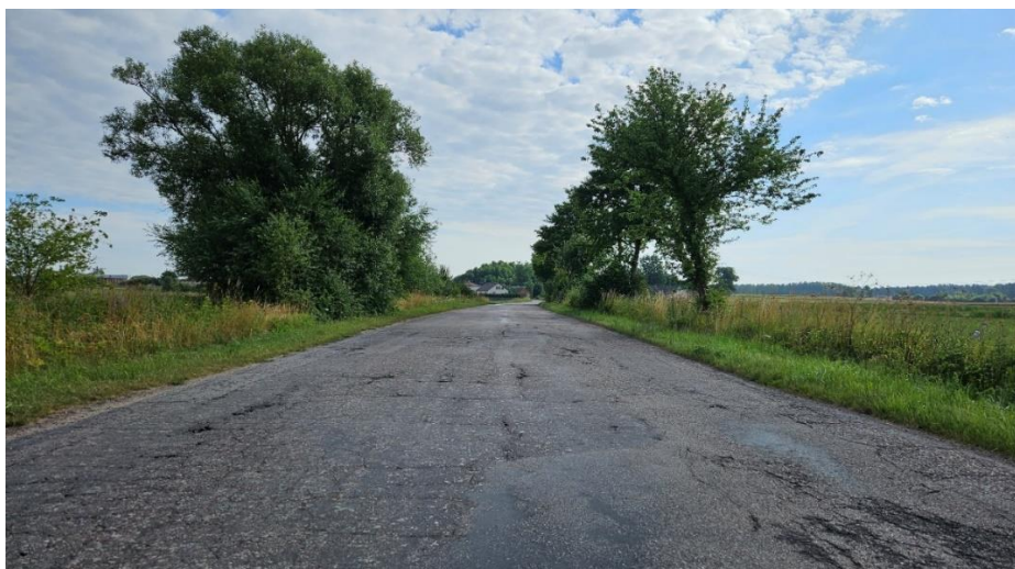
Fot. Droga powiatowa nr 1565B na odcinku Brzozow Stare – Brzozowo - Panki przed przebudową.
